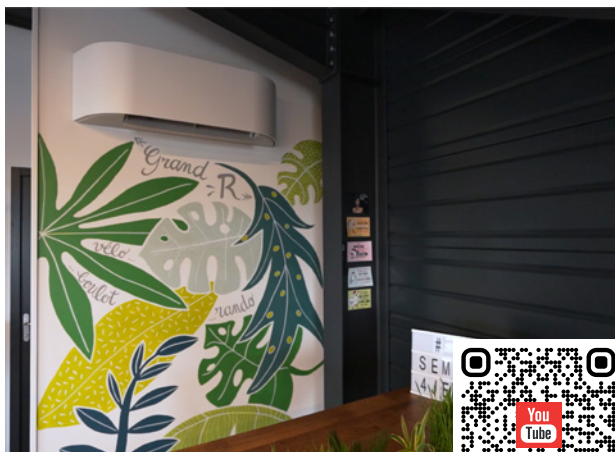
Colocworking S4J - Saint-Martin La Plaine / Installateur Le Froid Forézien - Crédit Photo Blue Production
